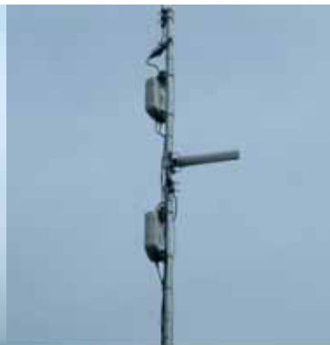
(役場屋上の機器)
